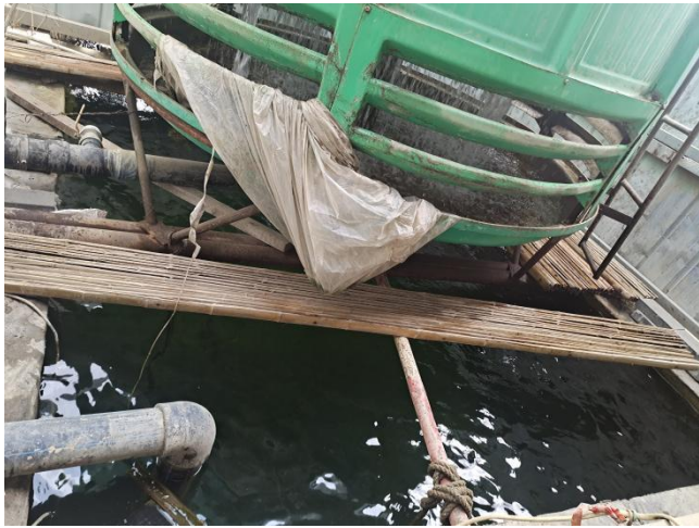
冷却循环水池
