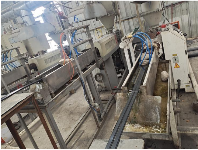
生产线冷却水收集槽
