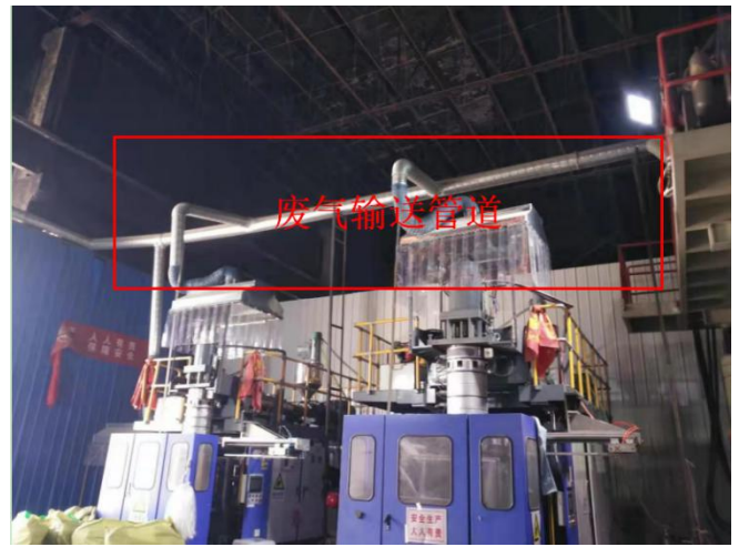
废气输送管道
