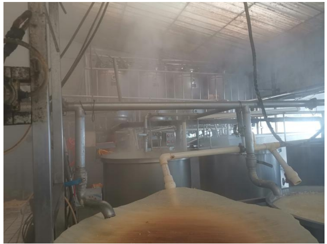
煮浆烧浆设备
