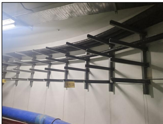
图 2、10KV 电力支架
