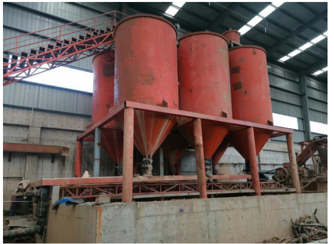
六级沉淀罐+沉淀池
