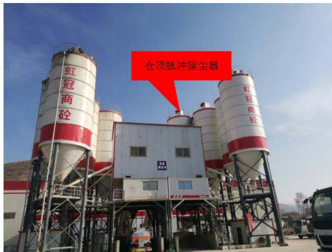
粉料筒仓脉冲除尘器
