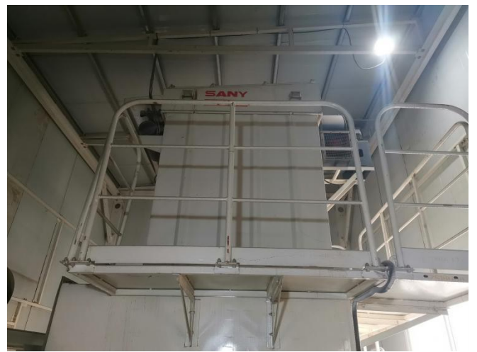
搅拌楼内袋式除尘器
