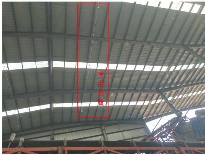
洗砂车间喷淋装置
