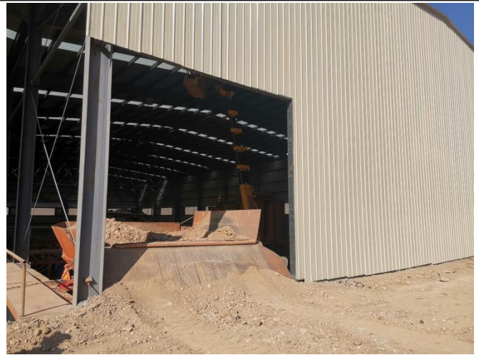
水洗砂车间上料口
