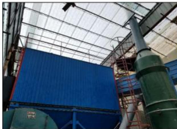
旋转炉粉尘除尘器及脱硫除尘塔
