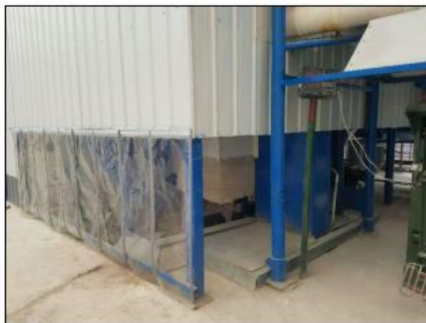
石膏粉磨工序粉尘收集设施
