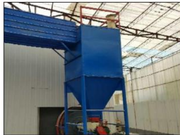
生料仓顶部自压除尘
