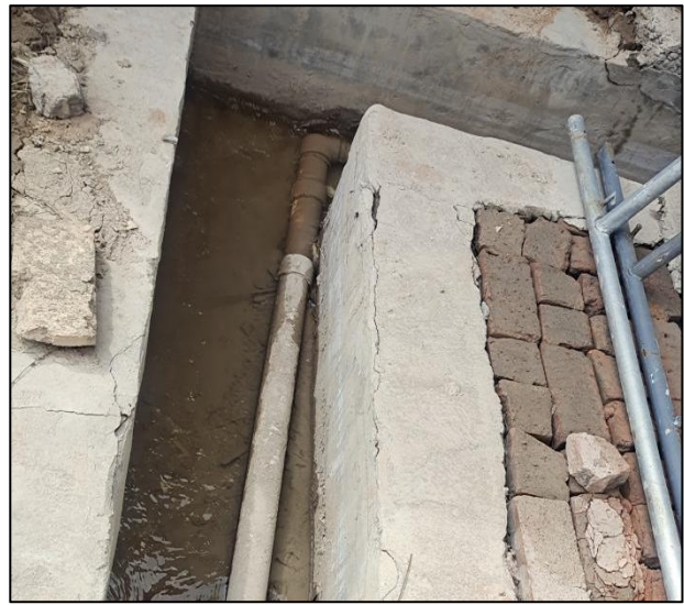
冷却水循环水池
